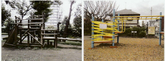
▲経年劣化した遊具
